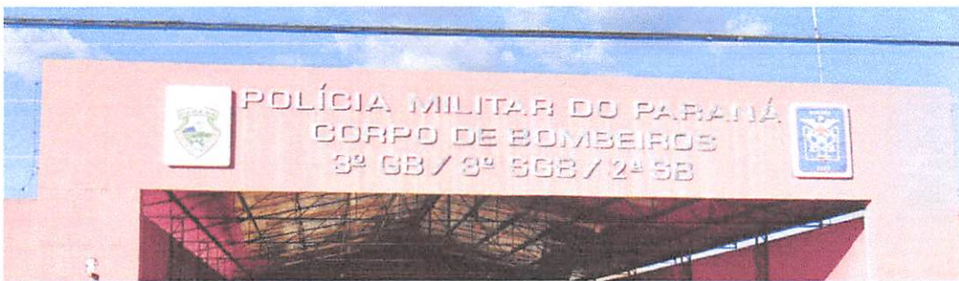
Letreiro da fachada, que será retirado, feito reparo de lixamento e pintura e depois reinstalado.
