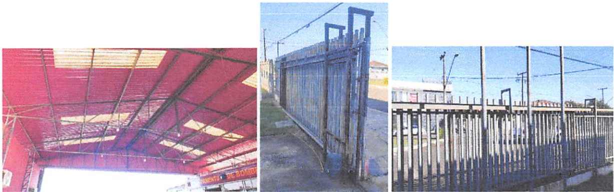
Toda estrutura metálica, grades e portões que serão reparados.
